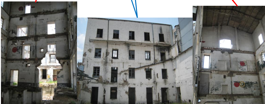
Foto 8 a Foto 10. Edificio donde se encontraba el molino, dos vistas interiores y una vista exterior. Puede apreciarse claramente la ausencia de todas las losas de entepiso. Fuente: Langarica 2011
