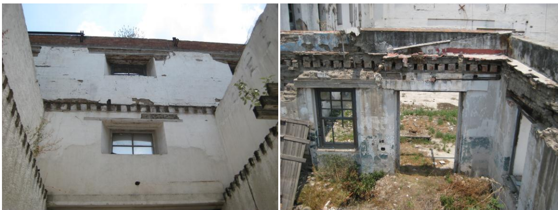
Foto 20 y Foto 21. Detalle de la ausencia de losas de entrepiso, mechinales y vigas recortadas, separadas a 20cm cada una Fuente: Langarica 2011
