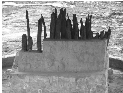
Figura I.14 Pilotes de madera utilizados como cimentación encontrados en el Templo Mayor de la Ciudad de México. OMG, 2013.
