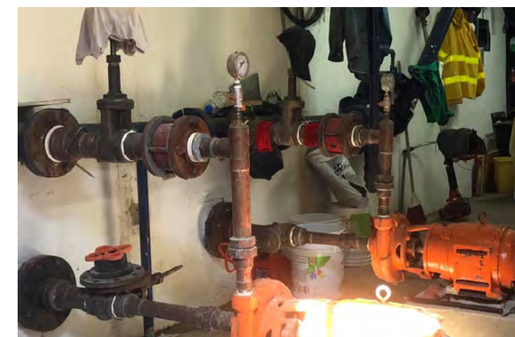
Imagen 76 Cuarto de máquinas. Fotografía Propia
