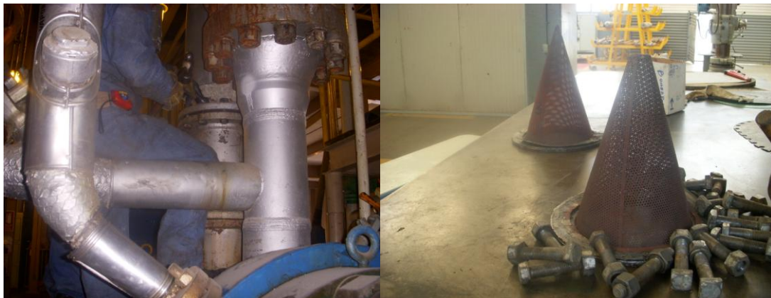
Figura 4.3. Limpieza de filtros de succión de la bomba de agua de alimentación.
