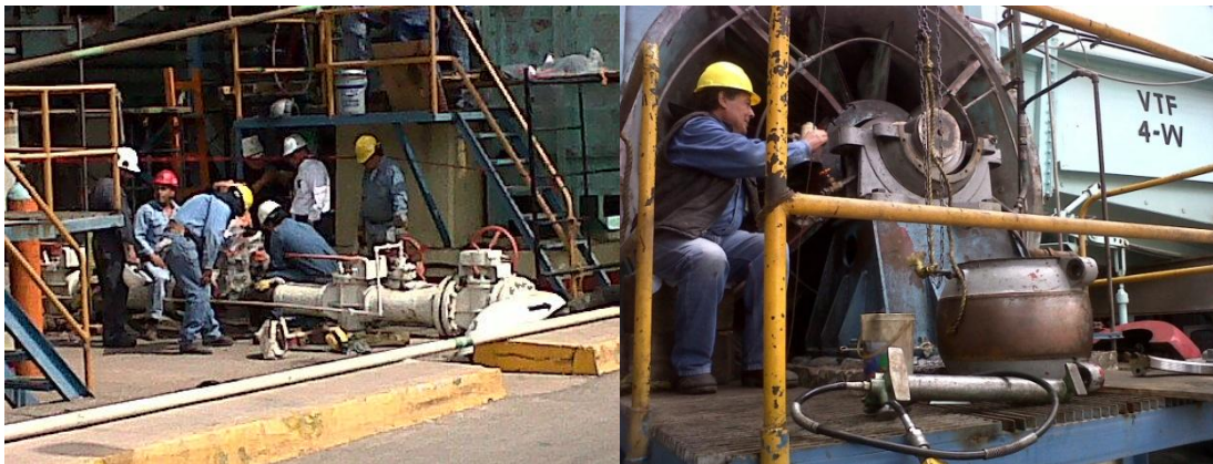
Figura 6.2. Revisión del ventilador tiro forzado.
