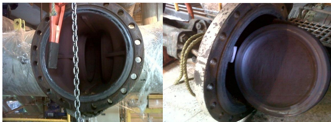
Figura 4.12. Limpieza de la válvula.
