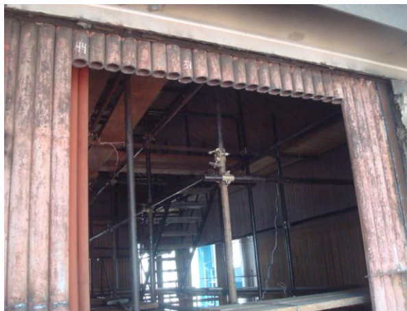
Figura 5.37. Elementos cambiados por CFE.
