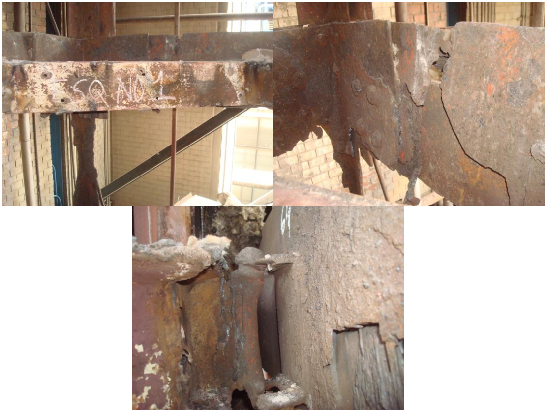
Figura 5.6. Placa y herraje dañados.
