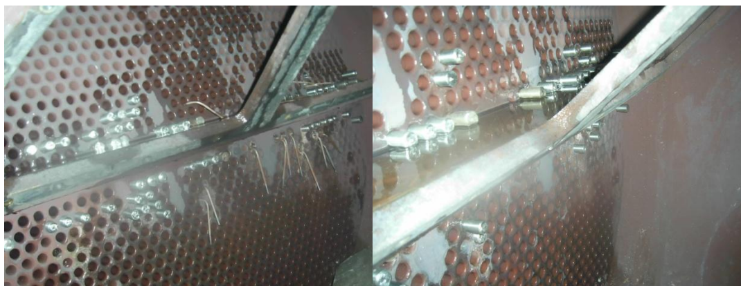
Figura 6.5. Cancelación de los tubos dañados.
