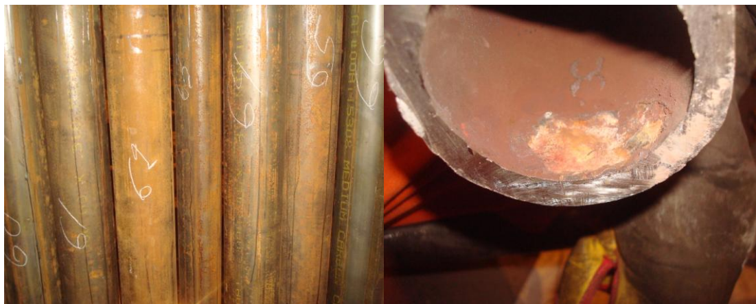
Figura 5.24. Eliminación de daño por hidrogeno.
