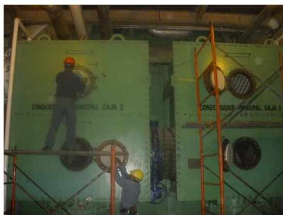
Figura 4.17. Apertura del condensador.
