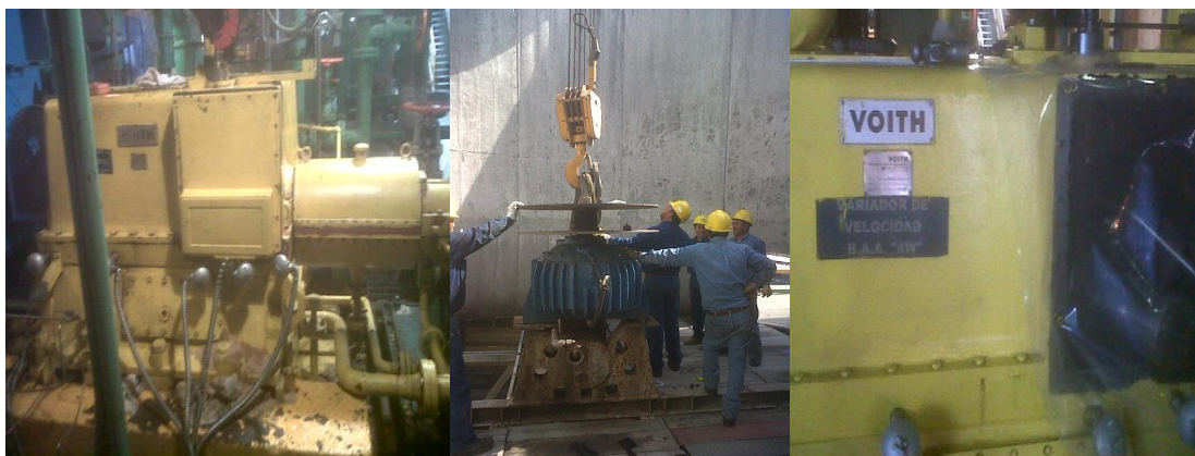
Figura 7.5. Equipos Voith en la CTVM.
