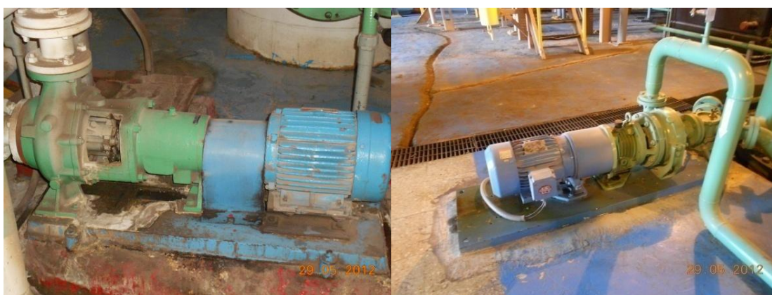
Figura 4.30. Mantenimiento a bombas de agua del sistema taprogge.
