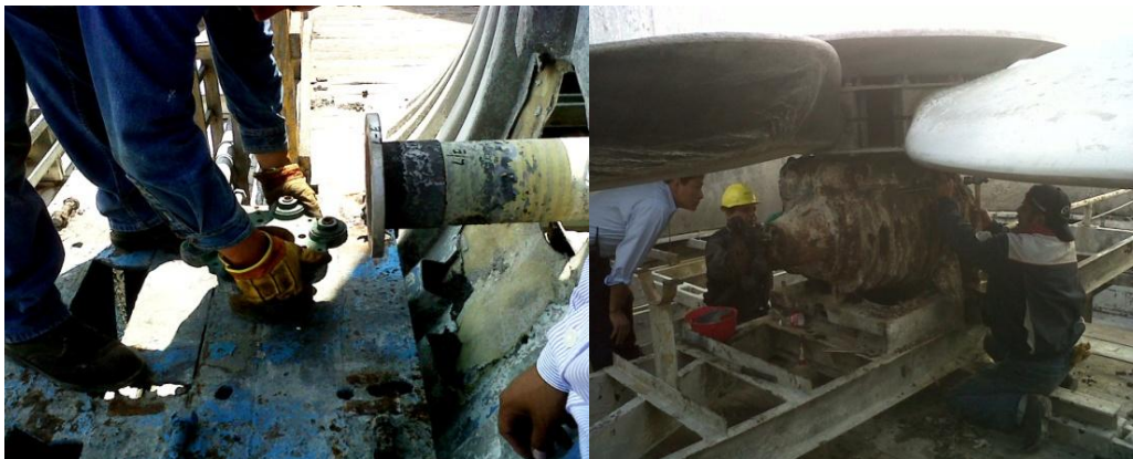
Figura 4.24. Desacople de los motores de las torre de enfriamiento.
