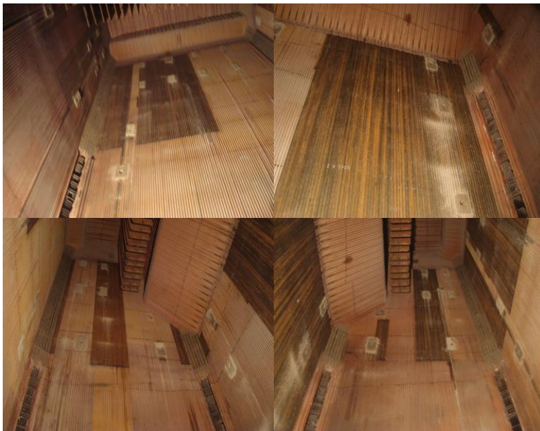
Figura 5.49. Generador de Vapor concluido.
