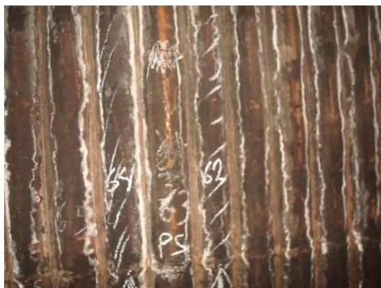
Figura 5.22. Daño por hidrogeno
