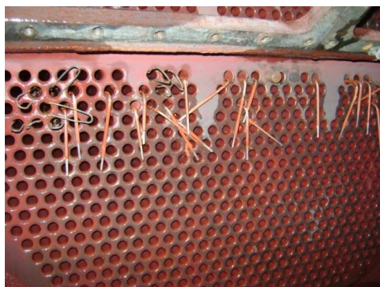
Figura 6.4. Se marcan los tubos afectados.
